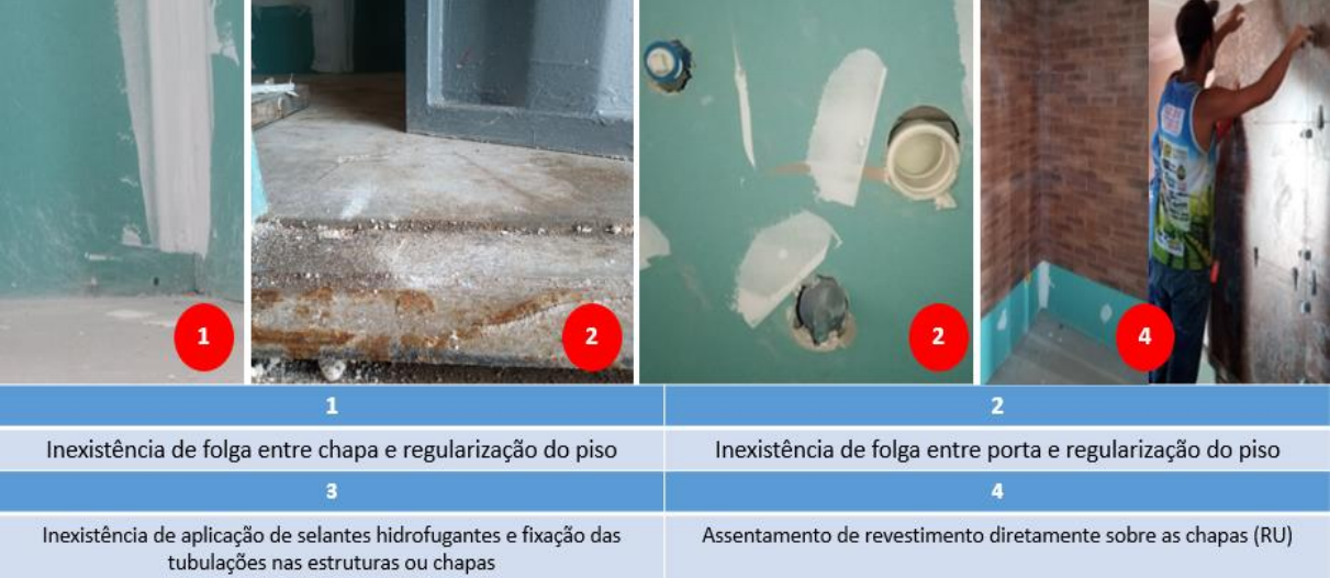
Figura 8 -Requisito das chapas – Falha de atendimento.
