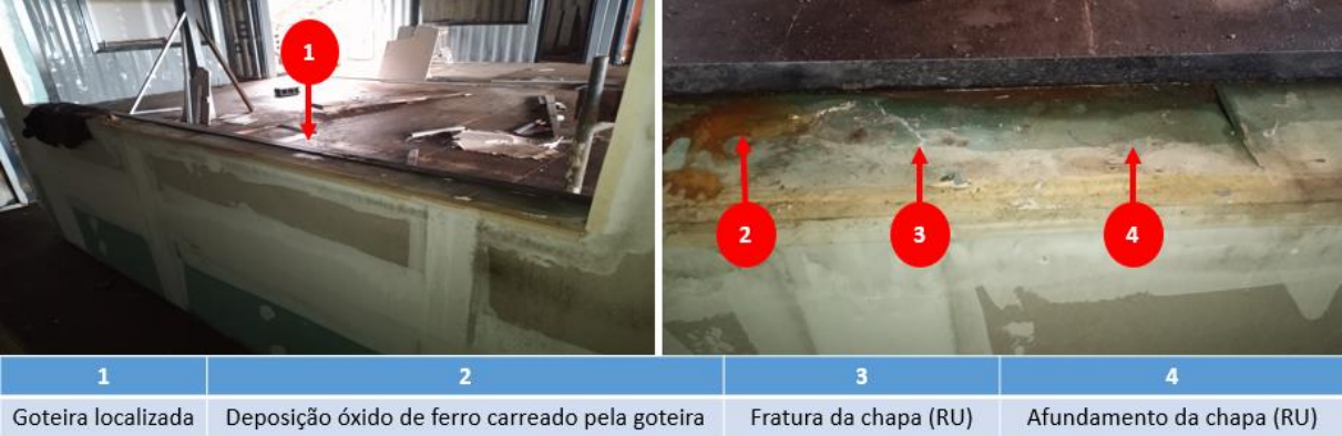
Figura 7 - Manifestações patológicas em divisórias de drywall .
