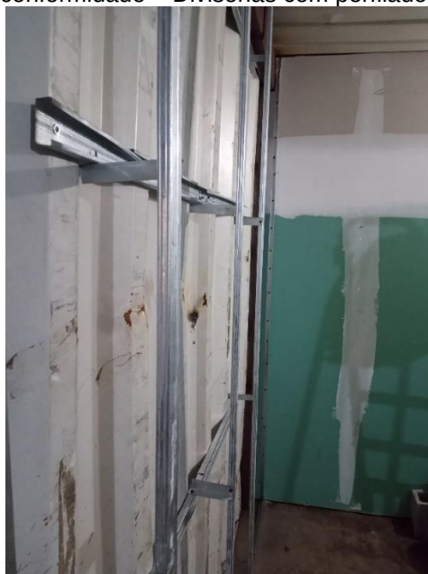
Figura 4 - Não conformidade – Divisórias com perfilado tipo canaleta C.
