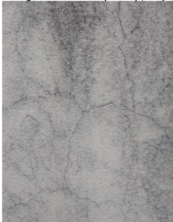
Figura 4 - Fissuras mapeadas (0,5mm).
