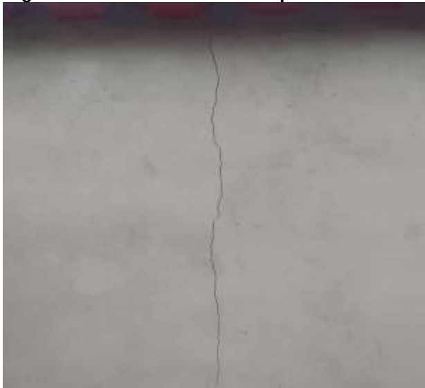
Figura 3 - Trinca vertical no corpo da alvenaria.
