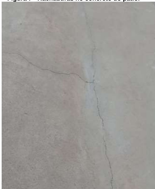
Figura 7 - Rachaduras no concreto do pátio.
