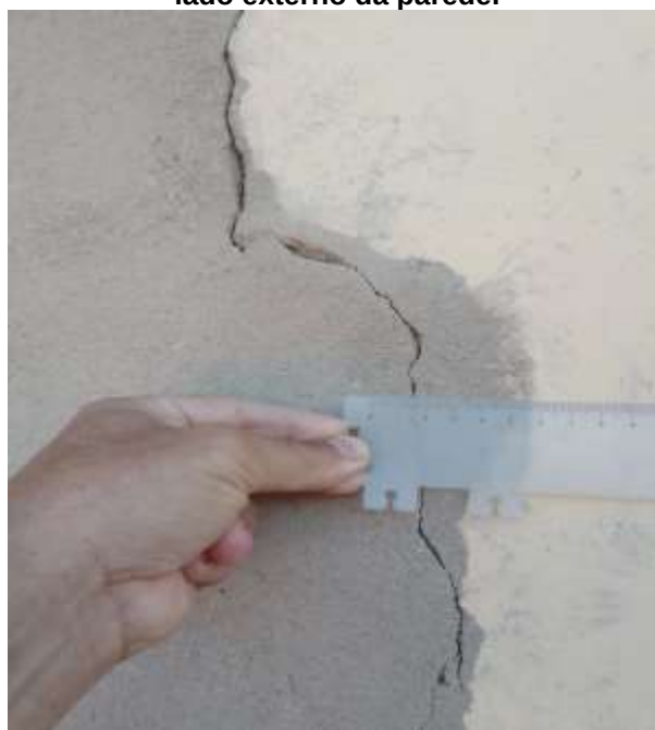
Figura 5 – Rachadura vertical com 1,5 mm do lado externo da parede.
