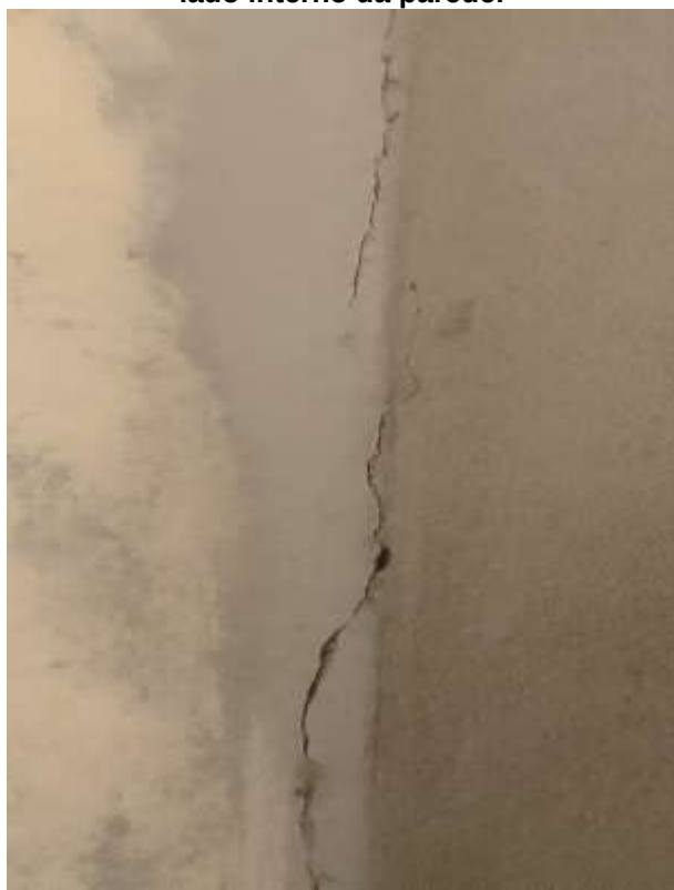
Figura 6 – Rachadura vertical com 1,5 mm do lado interno da parede.
