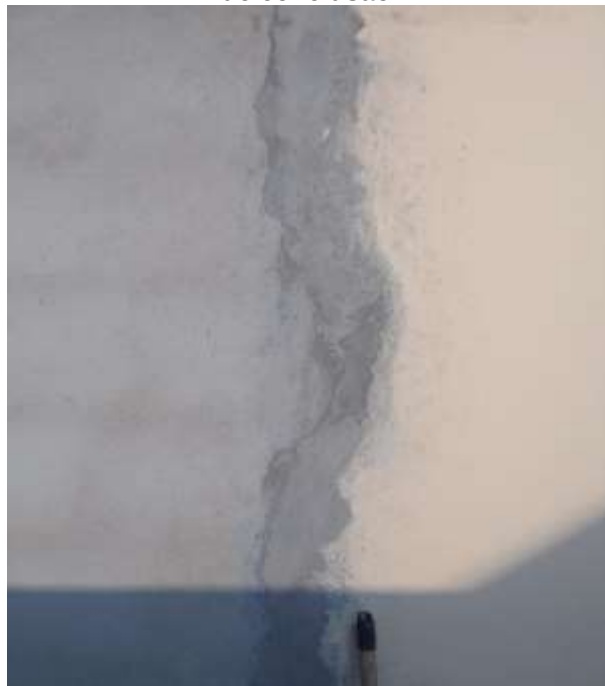
Figura 15 Tratamento da Figura 5 após 47 dias de conclusão.
