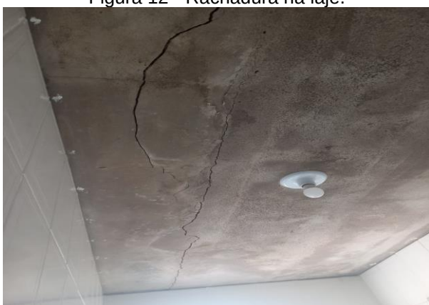
Figura 12 - Rachadura na laje.
