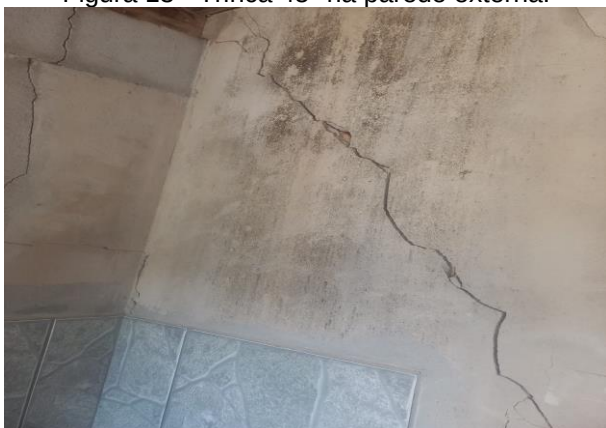
Figura 13 - Trinca 45° na parede externa.
