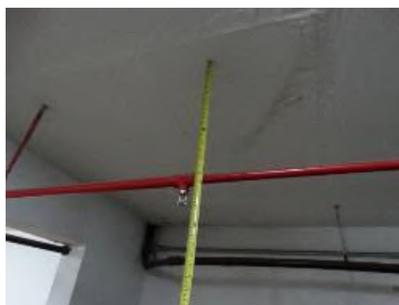
Figura 16: Posicionamento inadequado dos bicos de sprinkler em desacordo com a Norma NBR 10897/2014. Fonte: acervo do autor.
