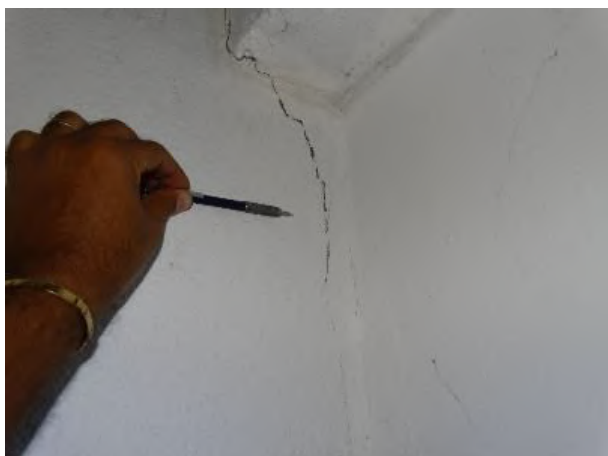
Figura 8: Manifestação patológica trinca na cortina do 1º Subsolo. Fonte: acervo do autor.
