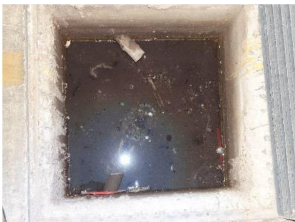
Figura 6: Caixas de passagem com acúmulo de água. Fonte: acervo do autor.
