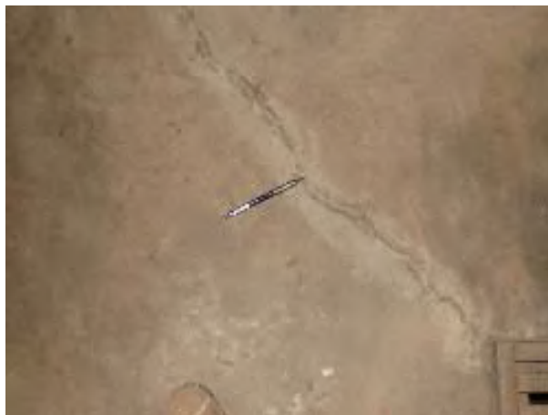
Figura 9: Piso de concreto do 2º subsolo com trinca. Fonte: acervo do autor.
