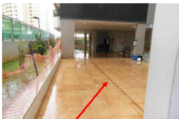
Figura 10: Junta de dilatação com falhas ocasionando infiltrações no subsolo. Fonte: acervo do autor.
