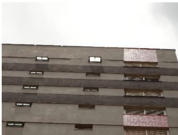
Figura 13: Parte da fachada do edifício que apresenta deslocamento da pingadeira. Fonte: acervo do autor.
