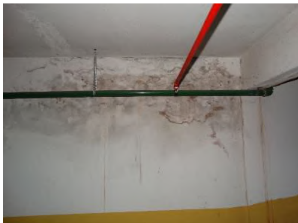
Figura 4: Manifestação patológica do tipo infiltração na cortina do 2º Subsolo. Fonte: acervo do autor.
