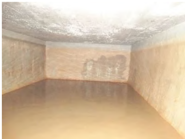
Figura 7: Infiltração no reservatório inferior de água potável do Bloco B. Fonte: acervo do autor.
