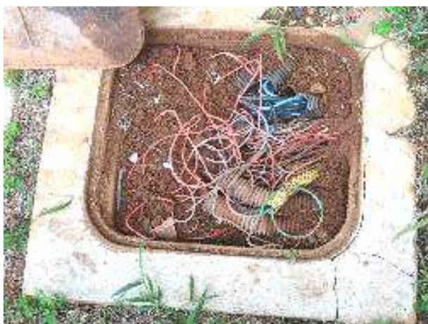
Figura 15: Caixa de passagem com fiação elétrica exposta e sem eletrodutos. Fonte: acervo do autor.
